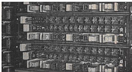
Telegraafautomaat te Amsterdam. Relais eenheid van lokaalregister.
